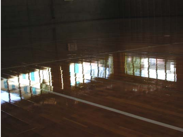
Sichtbare, aber verschlossenen, Fugen.
